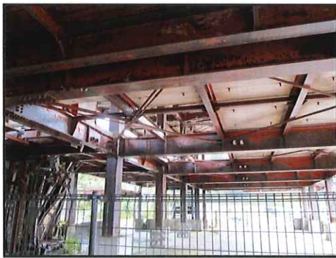
鉄骨のみとなったホテルの1階2階
